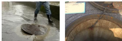
マンホールふた外れ
