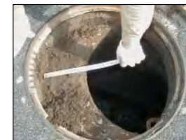
ボルト無緊結の古いタイプのマンホールふたの横ズレ
