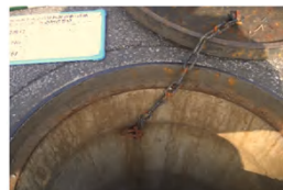
緩番の無いマンホールふた
